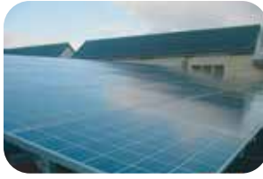
ソーラー発電 (10KW×4基)
