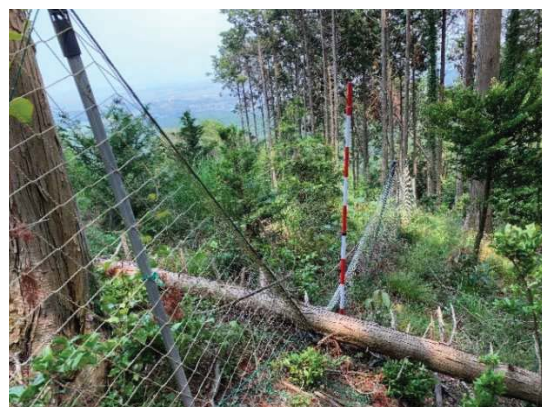
図 23 倒木による破損個所の状況（上仰木試験地）
