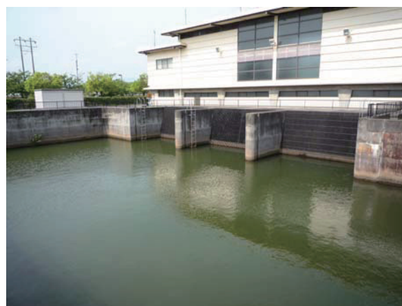
図10 長浜南部土地改良区の揚水ポンプ場
