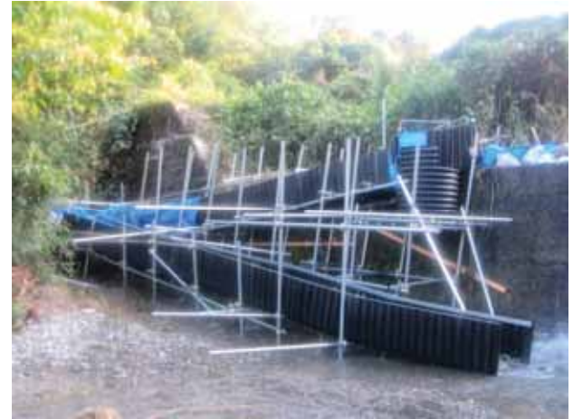
図 5-12 渋川の堰堤に設置した魚道
