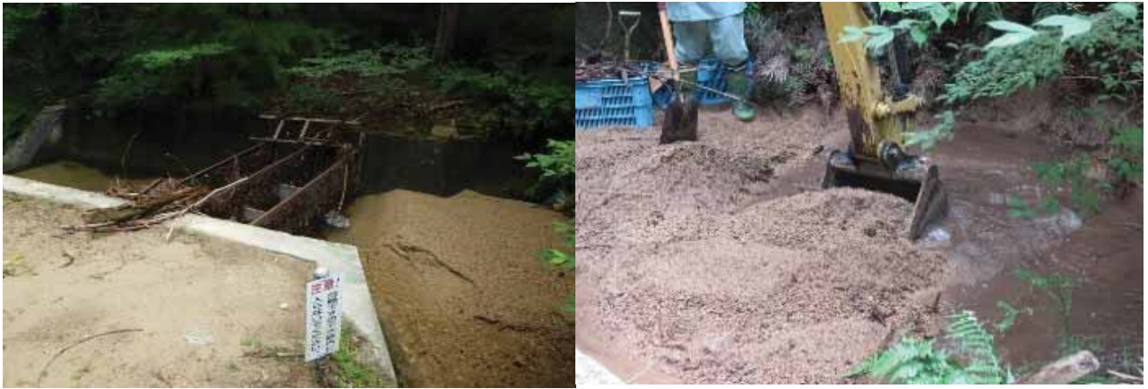
図 3-4 量水堰土砂堆積と回収時の写真
