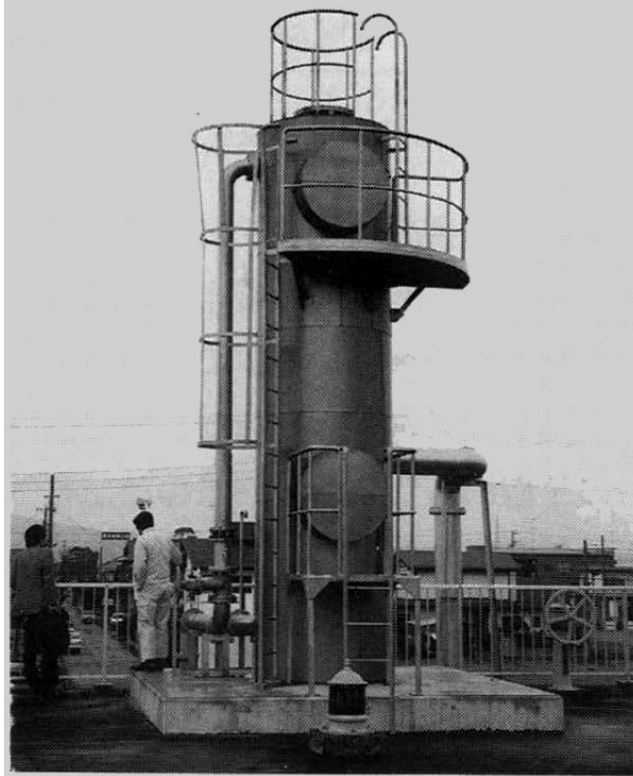
地下水から有機塩素化合物を取り除く曝気装置 (千葉県君津市の浄化場)
