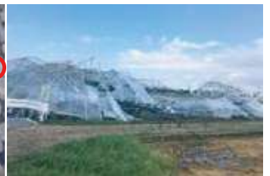
台風21号によるビニールハウス倒壊 (2018年9月)
